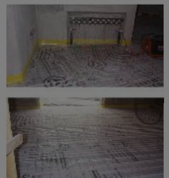
Pannelli a pavimento
